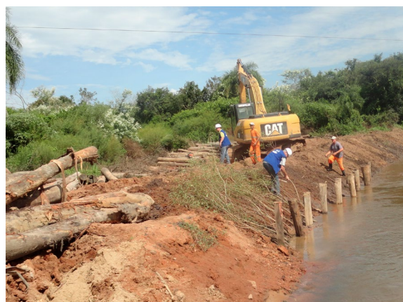
Figura 5: Disposição dos ramos de Phyllanthus sellowianus como feixes vivos entre as toras de madeira. Arroio Viúva Tereza. Coord. UTM: 399596/6567653 – 22S. Março 2014
