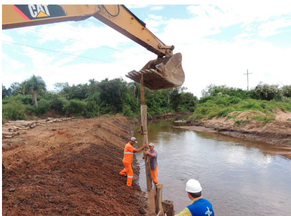
Figura 4: Estacas de eucalipto sendo cravadas na margem do arroio Viúva Tereza – construção da Parede Krainer. Coord. UTM: 399596/6567653 – 22S. Março 2014
